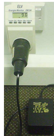
FIGURE 22.1. Une affreuse prise électrique de lampe de chez IKEA — elle consomme près de 10 W même quand la lampe est éteinte !
