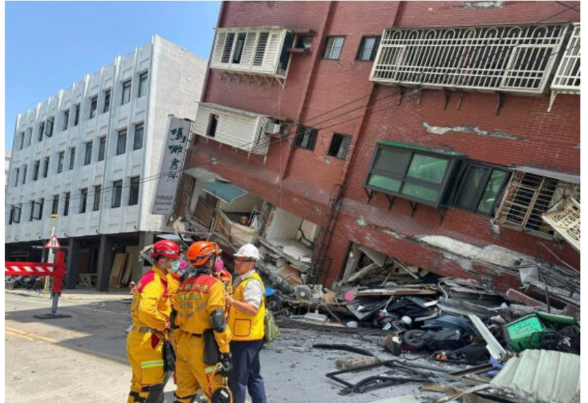
Des sauveteurs se préparent devant un bâtiment effondré à la suite d'un tremblement de terre à Hualien, dans l'est de Taïwan, le 3 avril 2024. AFP – LeMonde.fr
