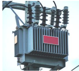
Transformateur de réseau
