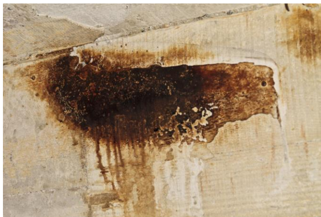
Traces d'urine sur un mur
