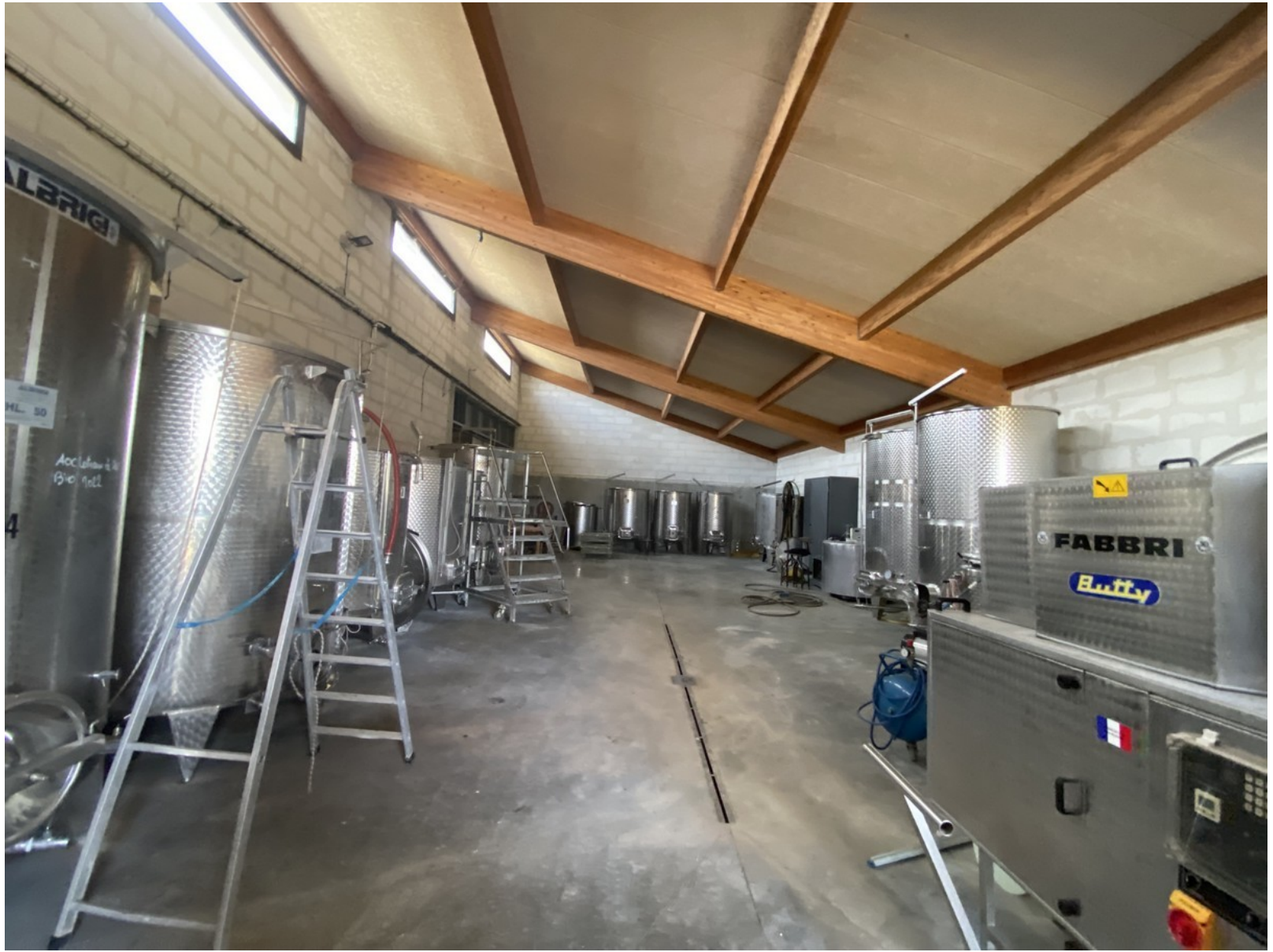
Cuve de maturation du vin du domaine Peylong
