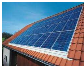
Les panneaux photovoltaïques utilisent l' énergie lumineuse du soleil pour produire de l'électricité.
