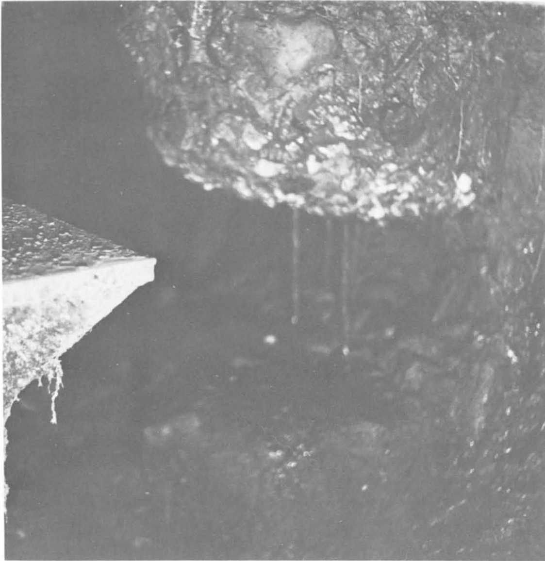
Fig. 4-25 - Difetto di esecuzione in un palo trivellato.
