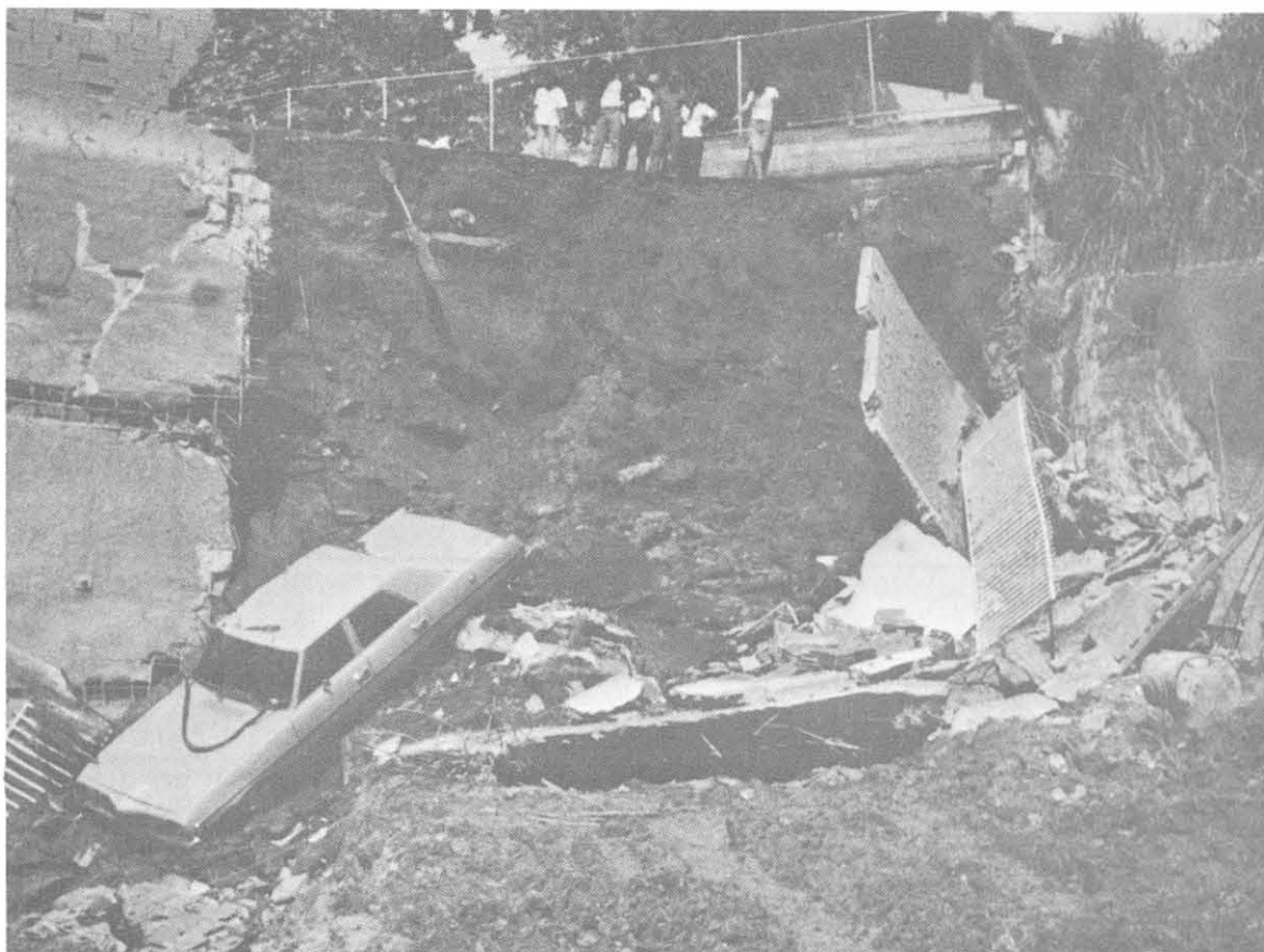
Fig. 19-9 - Franamento totale di una parete per il cedimento degli ancoraggi
