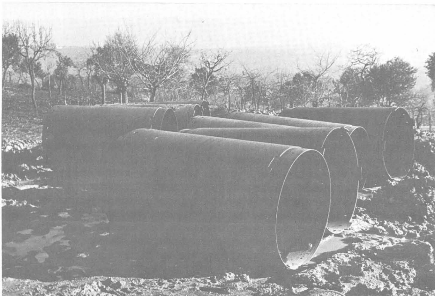
Fig. 6-5 - Tubazioni flangiate di 1,50 m di diametro.
