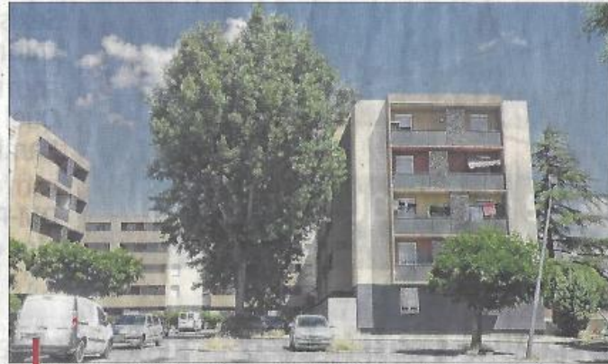
Des résidences réhabilitées mais des appartements squattés et des parties communes dégradées. / PH. CH.
