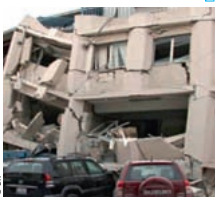
Immeuble prêt à s'effondrer
